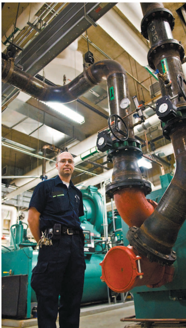
Jean-Marc Bourassa et son équipe veillent, entre autres, sur les immenses chaudières à vapeur du Complexe des sciences Pierre-Dansereau. | Photo: Nathalie St-Pierre
